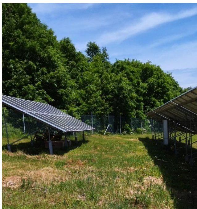
Фигура 32. Състояние на тревната покривка в действаща ФЕЦ край с.Заберново, Община М Търново
